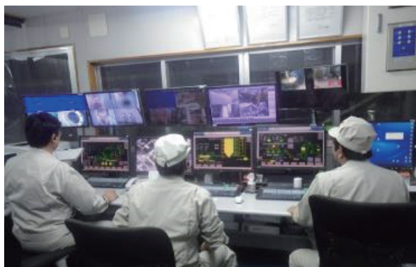
写真1 集中制御室の様子
