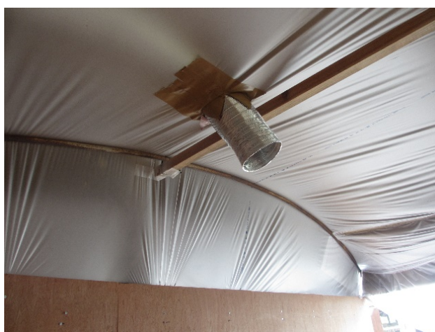
写真2：天井部からのスポットクーラーダクト
