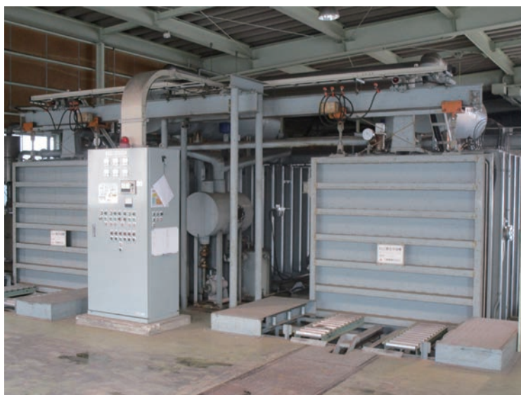
写真4 黒埼園芸センター管内の真空予冷施設
