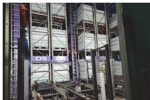
写真2 パレット自動倉庫導入により入出庫管理を自動化
