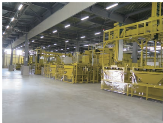
写真12 茎葉処理施設
