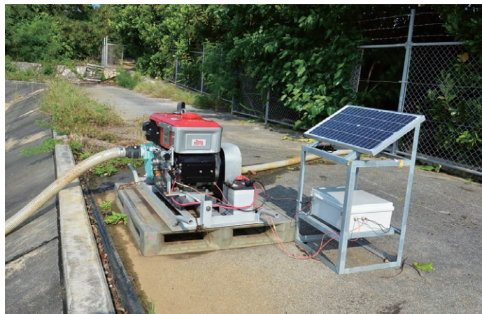
写真1 灌水制御ポストによる灌水ポンプの遠隔操作
